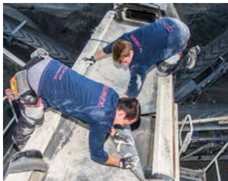
Zjištění rozsahu poškození dopravníkového pásu
